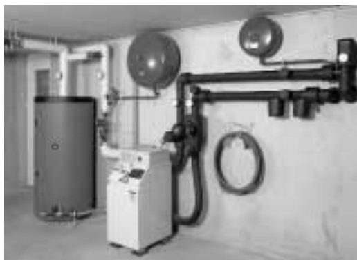
Pompa di calore geotermica
