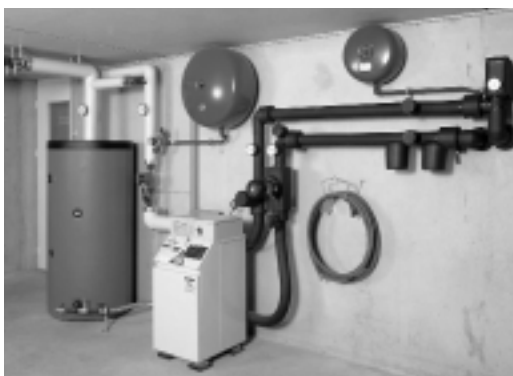
Installation de pompe à chaleur à sondes géothermiques
