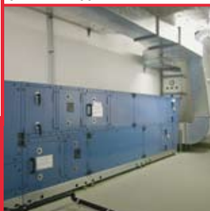
Appareil central d'aération au sous-sol d'un immeuble à plusieurs appartements
