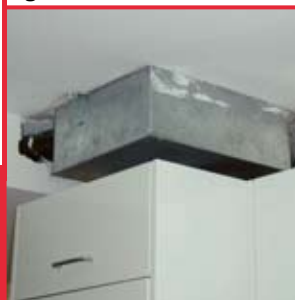
Caisson de répartition d'air installé dans l'espace clos d'un agencement de cuisine
