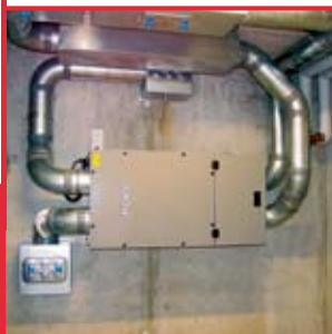
Un appareil d'aération décentralisé, installé en sous-sol
