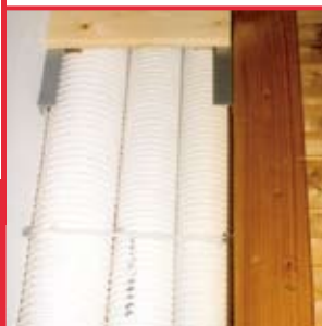
Conduits de distribution entre des chevrons
