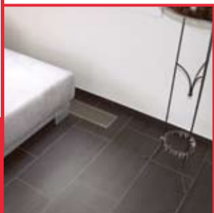
Zuluftauslass in Boden
