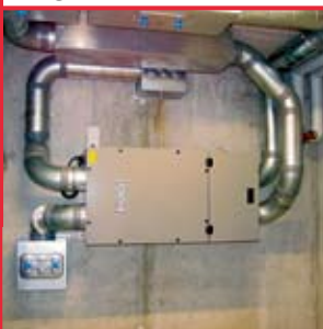
Eine Einzelwohnungs Lüftungsanlage, im Keller montiert
