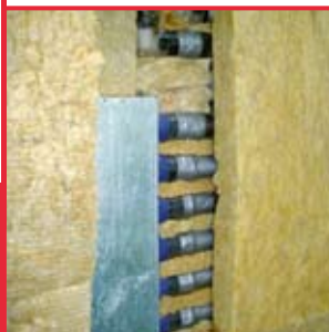
Luftverteilleitungen in der Dämmschicht der Fassade
