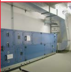
Mehrwohnungslüftungsanlage im Keller eines Mehrfamilienhauses
