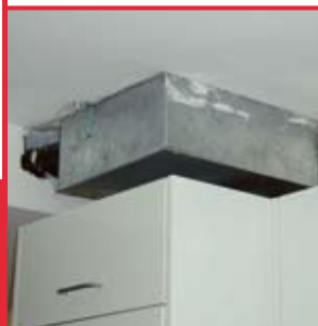
Verteilkasten im Blendenbereich der Küche
