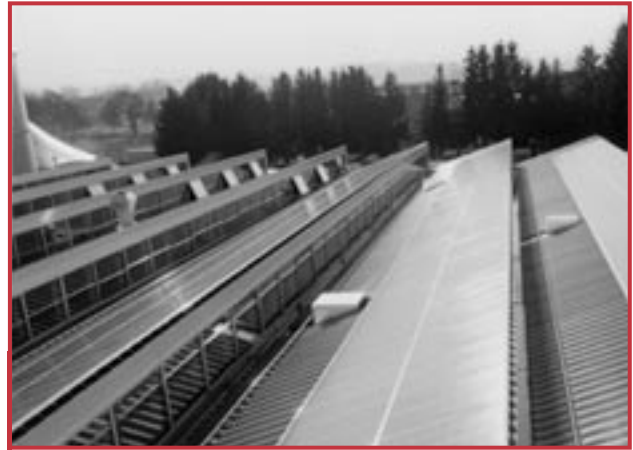
Ökostrom vom Hausdach: 505 m 2 Solarmodule.
