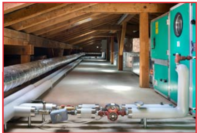
Verbesserte Energiebilanz dank Lufterneuerung: In den Lüftungseinrichtungen im Estrich wird die Abluftwärme auf die Zuluft übertragen.
